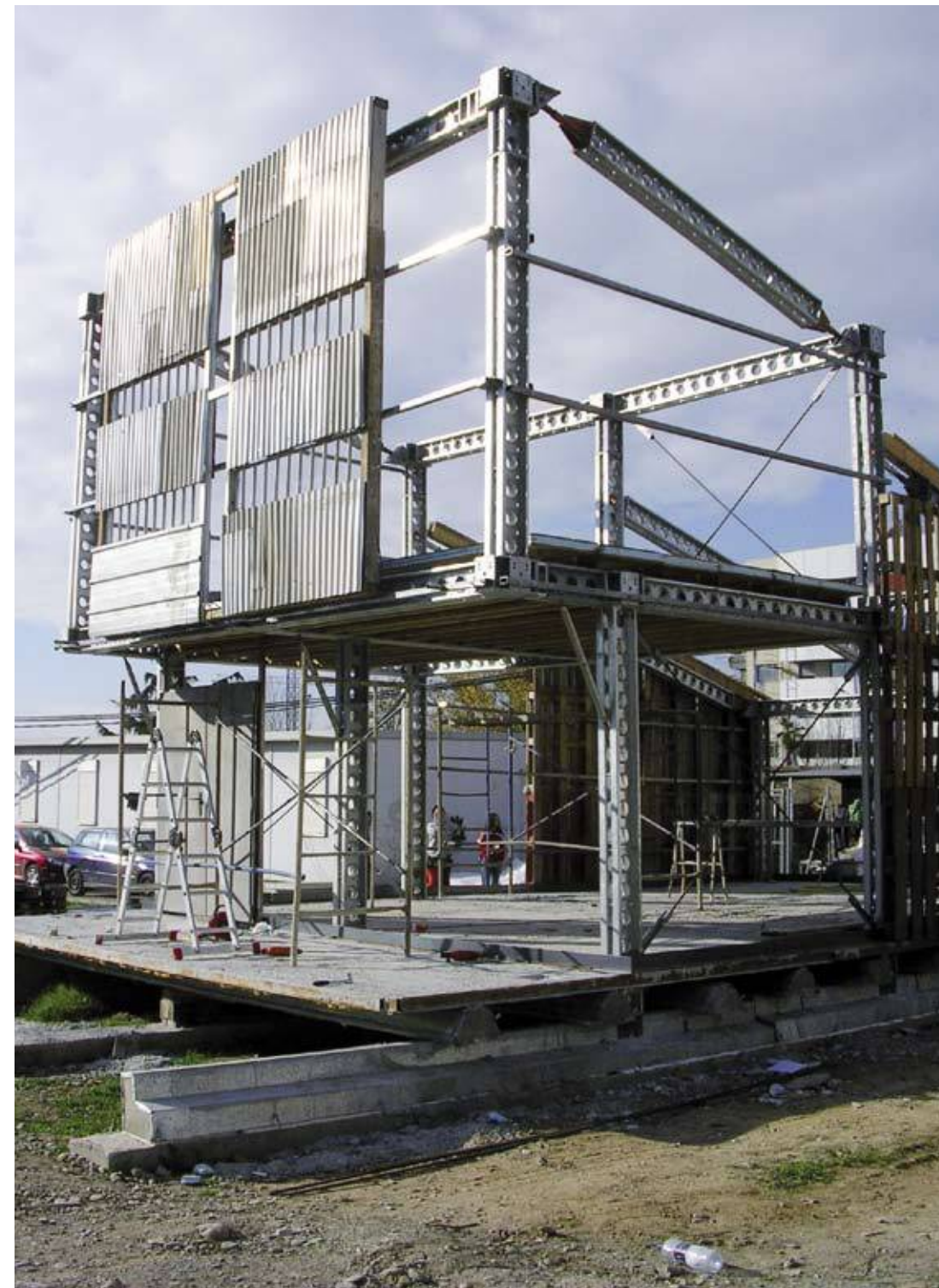
1 Construcció de l'aula AAABIERTA2. Procés de muntatge. Treball realitzat en el marc del taller «Talleres de construcció del aula: Cimentación, cerramientos, cubierta, estructura» (des de febrer a desembre de 2006). Projecte de Santiago Cirugeda per AAABIERTA.
